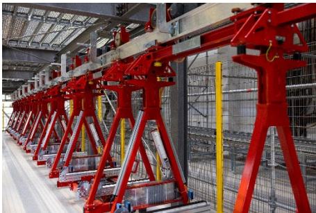
Pressefoto DAW SE – HRL9 – Elektrohängebahn.jpg
