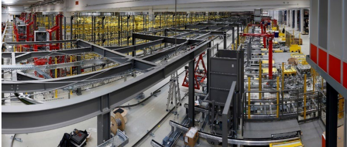
Pressefoto DAW SE – HRL8 – Elektrohängebahnen.jpg
