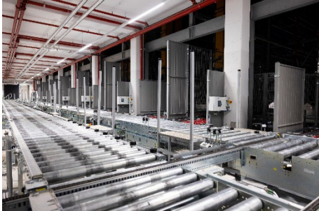
Pressefoto DAW SE – HRL1 – Blick über den Fördertechnik-Loop.jpg
